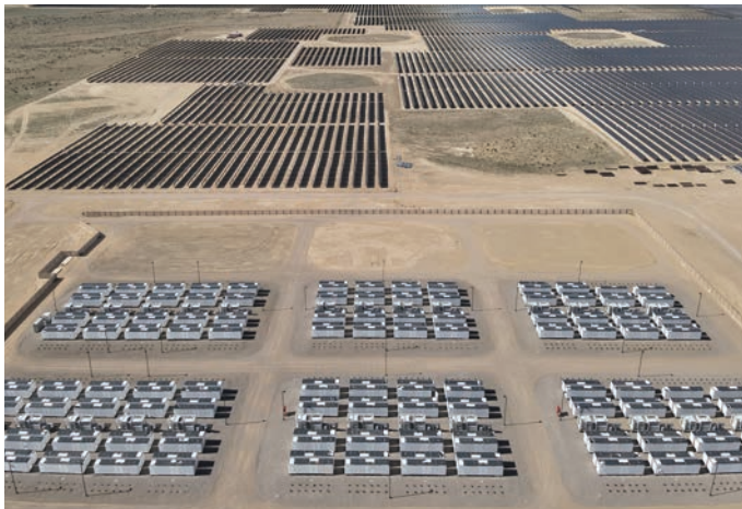
Franklin | Rogerson, Idaho | 240MWh
