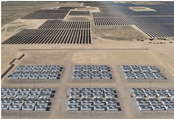
Franklin | Rogerson, Idaho | 240MWh
